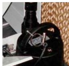
BOMBA DE AGUA GRUNDFOS CON REGULACIÓN DE CAUDAL Y SISTEMA DE DRENAJE CONTINUO PARA EVITAR LA CONCENTRACIÓN DE SALES MINERALES.
